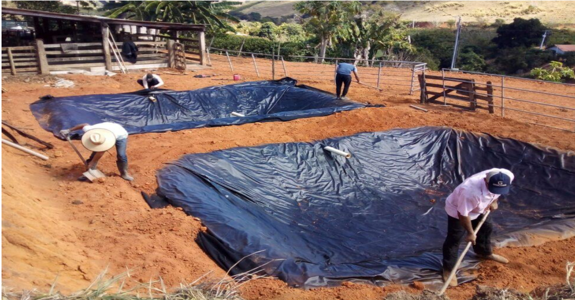
Figura 16. Construção de lagoas para tratamento de dejetos em Atílio Vivácqua. Fonte: Acervo Márcio Menegussi, 2023.
