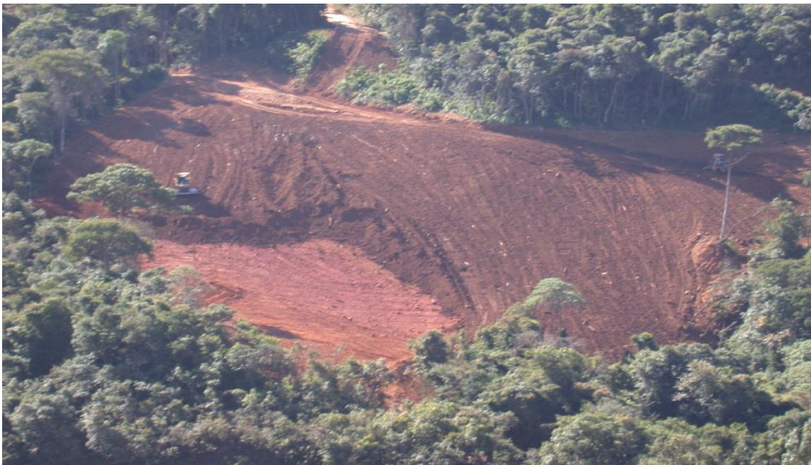
Figura 7. Distribuição do “topsoil” em local definitivo: restauração florestal em área de mineração de bauxita. Fonte: https://esalqlastrop.com.br/capa.asp?j=5 .
