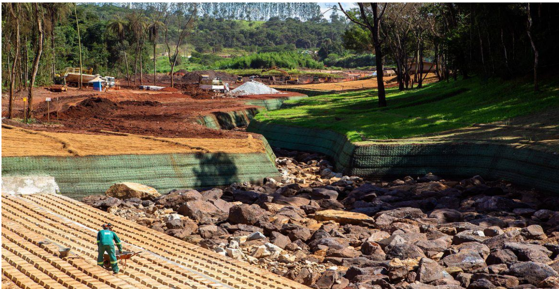
Figura 14. Curso de rio em processo de reconstrução na região de Brumadinho. Fonte: Fundação Renova (2022).
