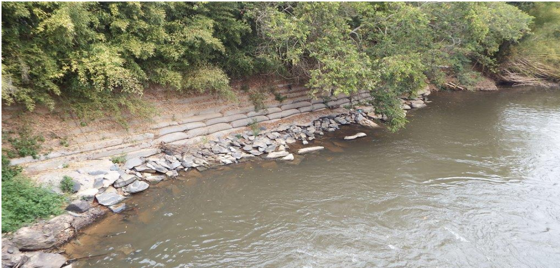
Figura 13. Margem de rio em Tiradentes, MG, com proteção de sacos com mistura de solo-cimento e água. Fonte: Arquivo Maurício Novaes (2018).
