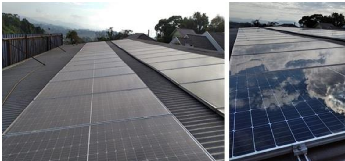
Figura 4. Painel solar antes e depois da limpeza.
