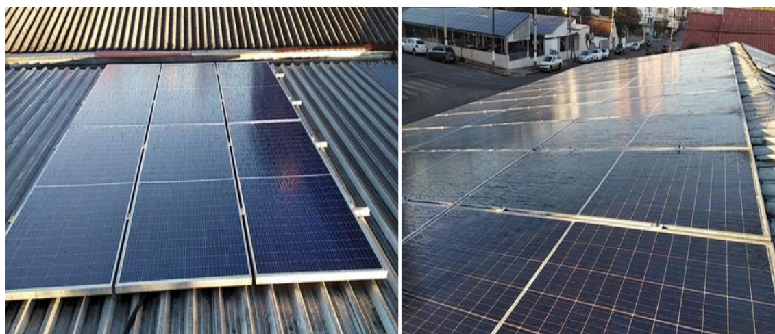
Figura 3. Painéis solares depois da chuva.
