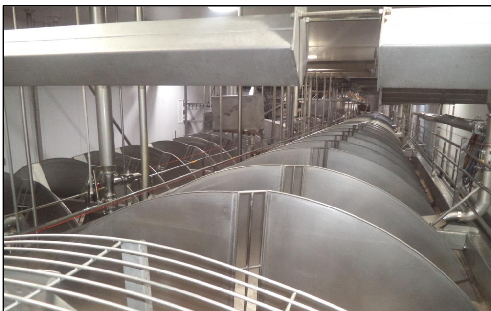
Figura 11. Tanques de Chiller de pré-resfriamento e resfriamento. Fonte: MARQUES, L. S. (2018).
