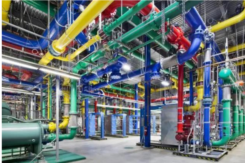
Imagem 1. Sistema de refrigeração do banco de dados da Google, na Carolina do Norte (EUA).
